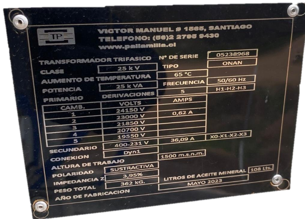
Figura 6-14: Fotografía de placa - Transformador de SSAA
