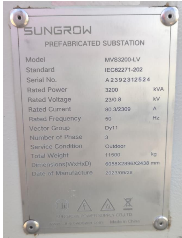
Figura 5-5: Foto de placa – Transformador principal
