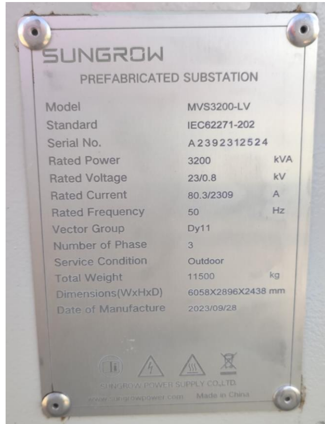
Figura 6-5: Foto de placa – Transformador principal
