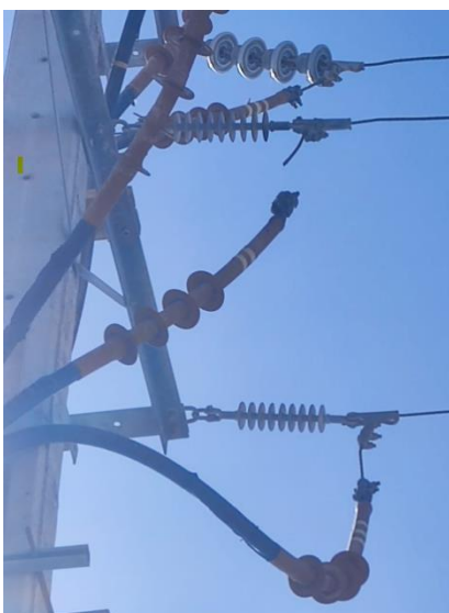
Imagen 1: Mufa cortada fase central de línea 23 kV Mejillones-City Gate.
